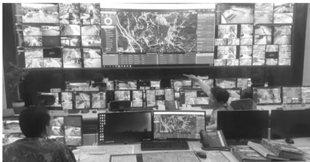
진안군 홍삼한방센터 2층에 위치한 CCTV통합관제센터는 289㎡ 규모로 관제실, 사무실, 회의실, 통신실 등을 갖추고 있다.
