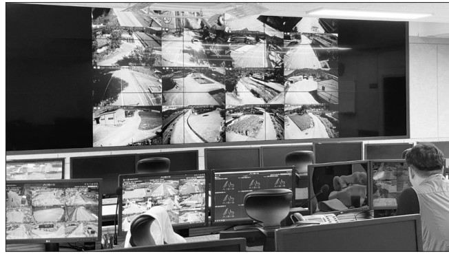
장수군 CCTV통합관제센터 내부
