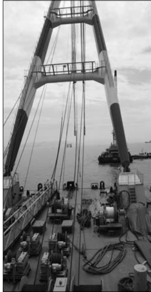
위도 앞바다 서남 해 해상풍력이 순조롭게 진행되어 해상변전소 하부가 완료되고 10월 말 3기 풍력발전기가 완공될 전망이다.
