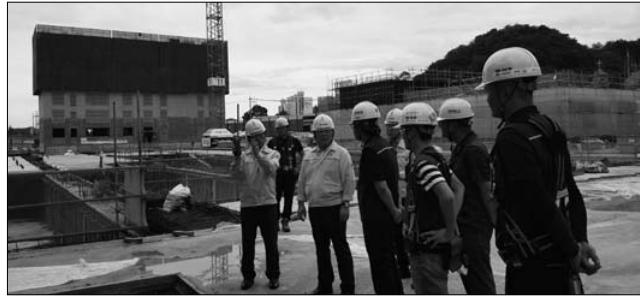
이승복 부시장은 23일 관내 공동주택 건설현장을 직접 찾아 태풍 피해 대비에 만전을 기할 것을 강조하며 건설공사로 인한 피해가 없도록 모든 행정역량을 집중해 달라고 당부했다.
