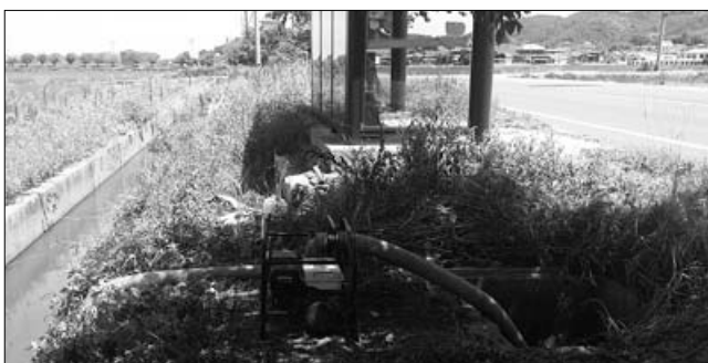
나뭇잎 서지제 등 저수율이 낮아 급수가 필요한 저수지 11개소에는 긴급 임시 양수관로를 설치하고, 양수장 30개소 및 대형관정 76개소를 이용해 1일 10만 톤의 저수지 물 채우기와 용수를 공급하고 있다
