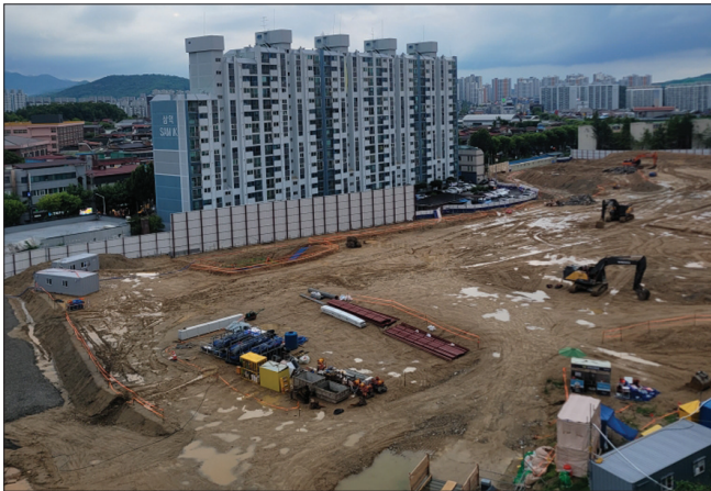
전주 삼천 주공 3단지 재개발 철거 공사를 둘러싸고 인접 아파트 주민과 상인들이 소음과 분진, 비산먼지 피해를 호소하며 대책 마련을 요구하고 있다.
