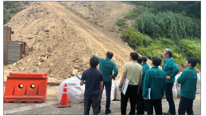
김인태 전주 부시장은 지난 3일과 5일 취약지역 현장점검을 통해 여름철 집중호우 대비 대응 상황과 공사 현장에 대한 안전관리 실태를 점검하고, 정비사업 추진 상황 등을 청취했다.
