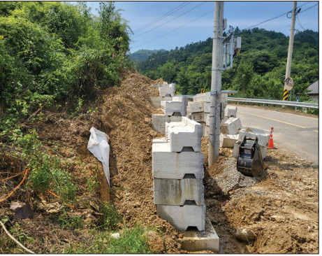
무주군 군도5호선(내동지구)선형개선 공사 현장에서 공사 과정에서 쌓아놓은 옹벽블록(보강토)이 무너지고 용수로 하단 쇄골이 드러났다.
