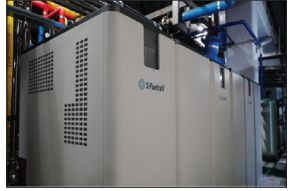
전주시설공단은 친환경 발전설비인 수소 연료전지를 도입하며 완산수영장에 40kW 용량의 수소 연료전지를 설치해 운영 중이다.
