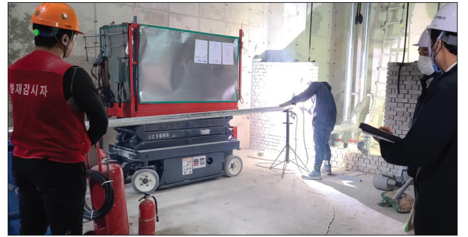
전주덕진소방서는 공사 현장에서 용접·용단 작업 시 불티 화재에 각별한 주의를 당부했다.
