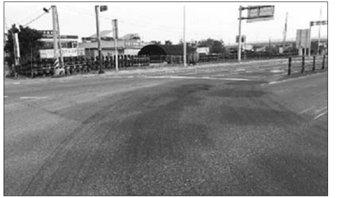
용진 진입로 입구 도로변 포트홀 '위험' 전주 용진~완주 용진간 도시외곽도로 용진 진입로 입구 도로변이 허우리를 지나면 포트홀이 생기고, 이를 시공사가 반복 보수하는 현상이 벌어지면서 사고 위험은 물론, 근본적인 대책이 시급하다는 지적이다. /완주=이종복 기자
