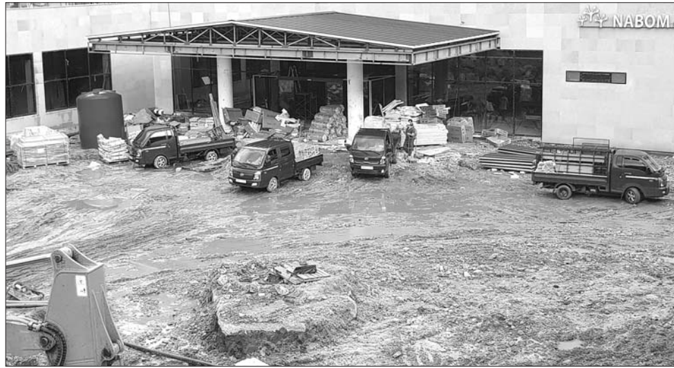
H건설은 무주군 나봄 리조트 공사 현장에 탁류 옥탑방지 시설을 갖춰야 함에도 이를 이행하지 않고 공사를 강행하고 있다.
