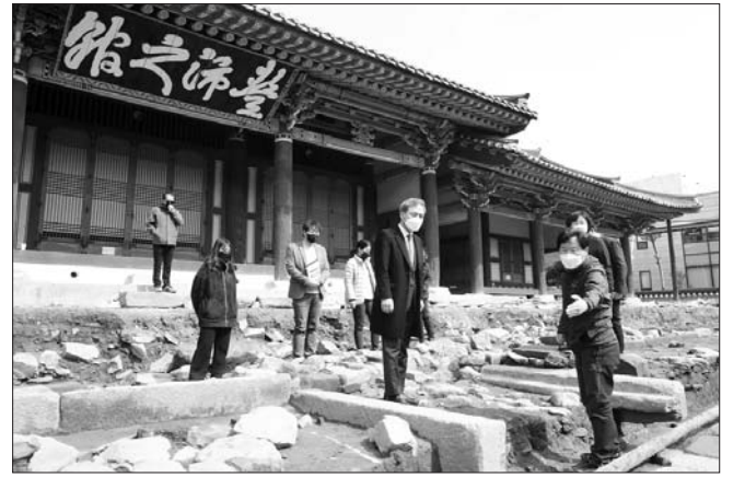
전주 풍패지관을 찾은 김승수 전주시장 김승수 전주시장은 22일 발굴 조사를 통해 조선전기예 축조된 월대 시설과 고려시대 건물지, 통일신라~후백제의 대지조성층 등이 확인된 '전주 풍패지관'을 찾아 발굴조사 성과에 대해 보고를 받고, 고려시대 건물지 등을 둘러보며 복원·정비 계획에 대해 논의했다.
