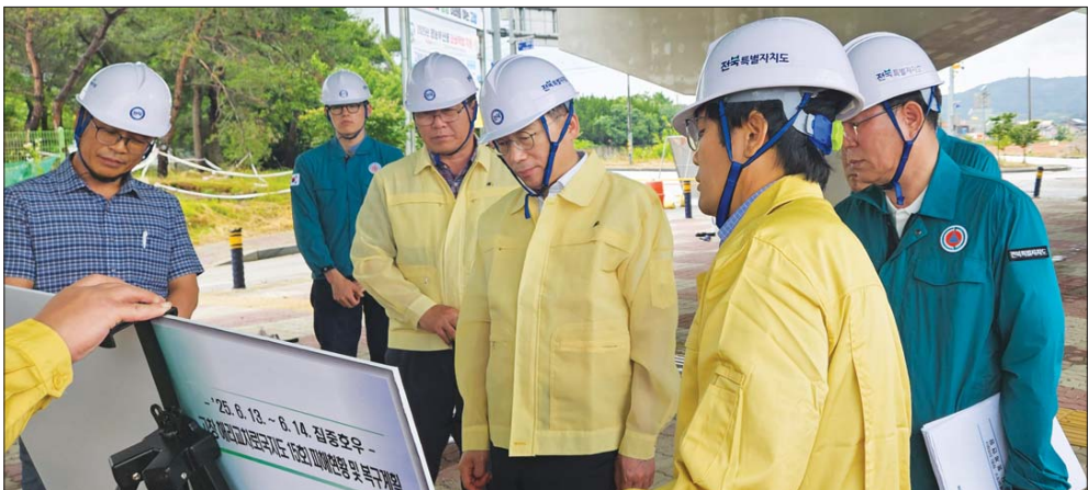
노홍석 전북특별자치도 행정부지사는 최근 집중호우로 옹벽 붕괴가 발생한 고창 국지도 15호선 현장을 직접 찾아 응급복구 진행 상황을 점검했다.
