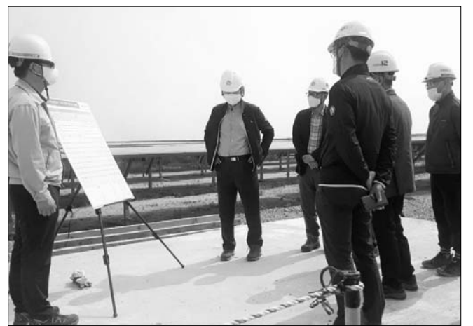
강팔문 새만금개발공사장은 23일 군산시 오식도동에 위치한 새만금 육상태양광 1구역과 3구역 건설 공사 현장을 방문해 공사 현장 관계자들을 격려하고, 여름철 집중호우 대비 안전사고 예방과 철저한 현장 관리를 당부했다.
