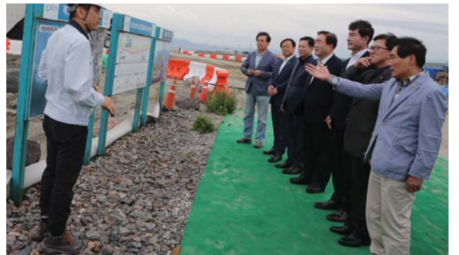
환경복지위원회는 고군산군도 연결도로와 동서도로 공사현장, 점버리 예정부지 등을 방문해 진행상황 등을 점검했다.
