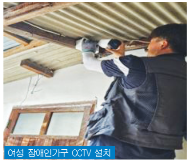
여성 장애인가구 CCTV 설치
