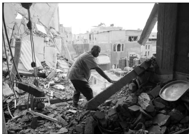
7일(현지시간) 가자지구 남부 라파에서 한 주민이 이스라엘의 공습으로 파괴된 건물 잔해를 살피고 있다. 팔레스타인 보건부는 이스라엘의 라파 공습으로 최소 20명의 팔레스타인인이 숨졌다고 밝혔다.
