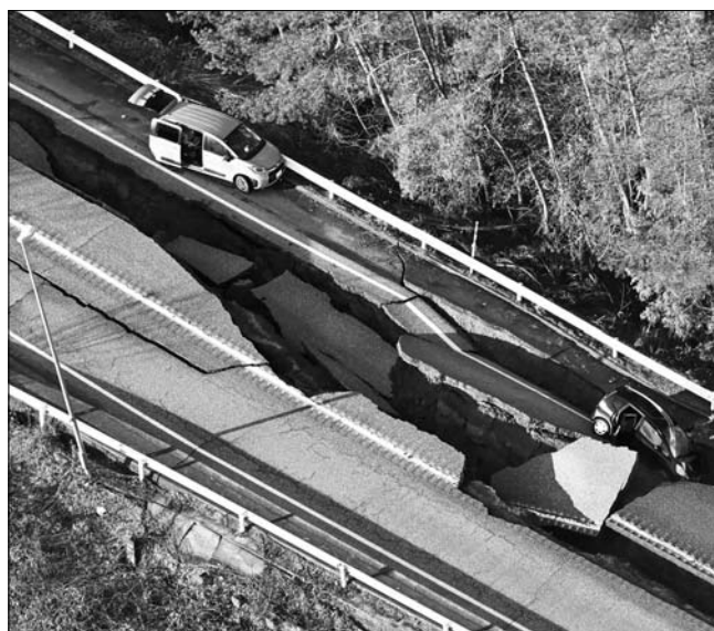
일본 이시카와현 노토반도에서 발생한 지진으로 2일 아나미즈마치의 도로가 갈라져 있다. 기시다 후미오 일본 총리는 비상재해대책본부 회의를 열고 "이재민의 구명·구조는 시간 싸움"이라며 "주민 안전 확보를 최우선으로 전력을 다해줄 것"을 주문했다.
