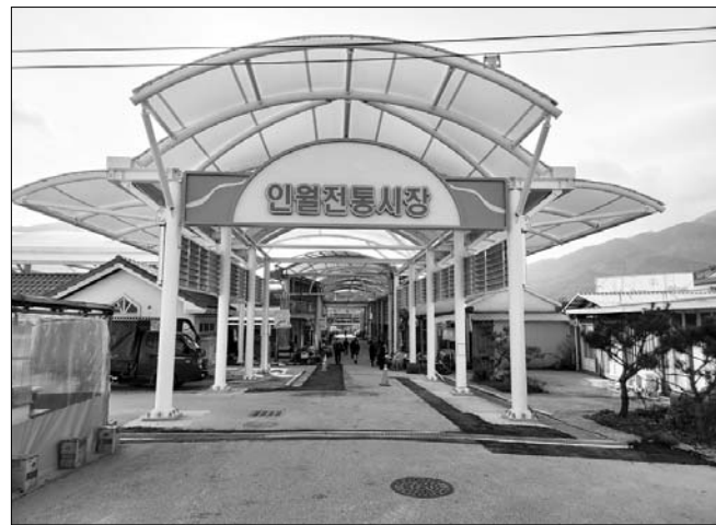
남원시는 총사업비 5억원을 들여 지난 5월부터 공사에 착수, 길이 35m, 폭 7.5~11m, 연면적 348㎡ 규모의 아케이드를 인월시장 입구에 설치했다.
