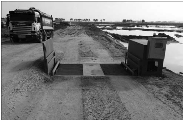
세차 시설·살수차량 미비 등으로 비산먼지 문제가 심각한 섬진제 저류지 준설 현장
