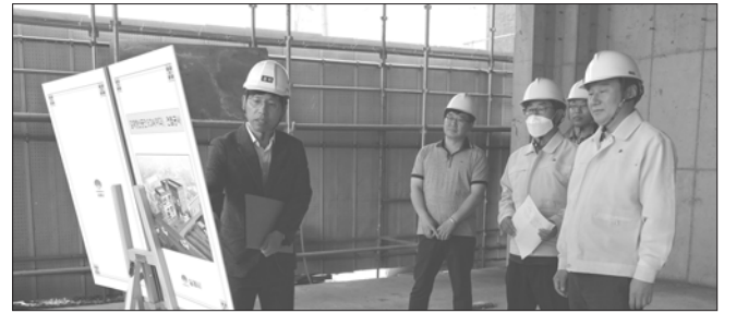
김제시 허전 부시장은 조성 중인 김제청년공간 E :DA(이디)건립공사 현장을 방문해 추진상황을 점검했다.
