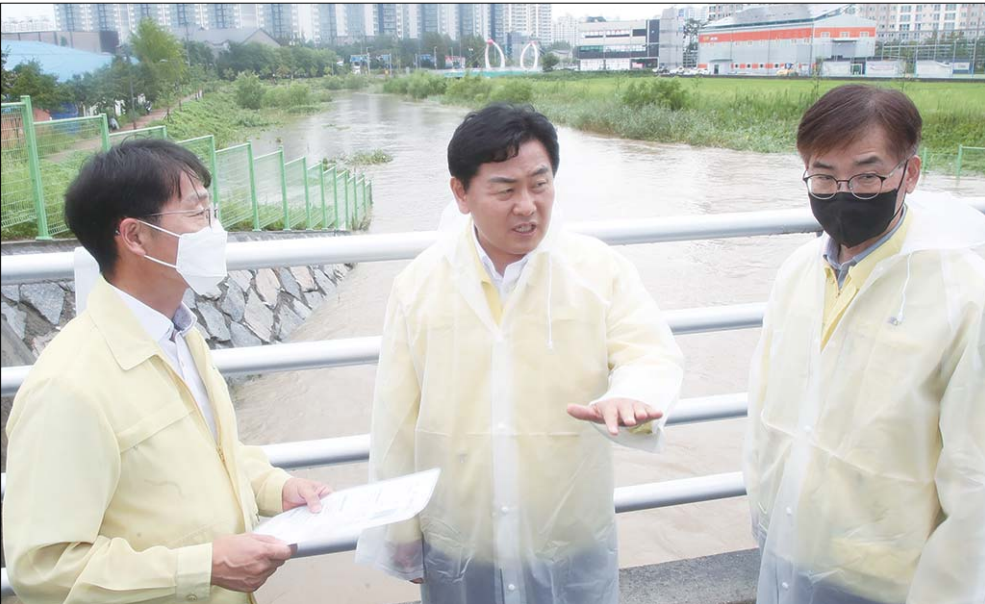
11일 전북지역에 집중호우로 인한 피해가 발생하고 있는 가운데 물에 잠긴 군산 옥회천 공사현장을 찾은 김관영 전북도지사가 직접 현장을 지휘하며 공무원들에게 피해 최소화과 예방에 선제적·과감하게 대응해줄 것을 주문하고 있다.
