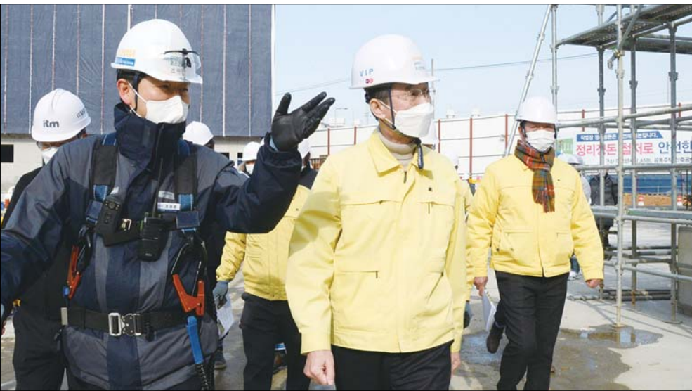
송하진 전북도지사가 8일 군산시의 한 신축 아파트 건설현장을 방문해 '주택 건설 현장 안전점검'을 하며 관계자들과현장을 둘러 보고 있다.
